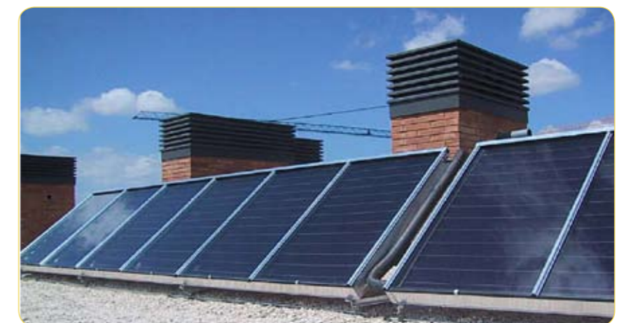
La base de un panel solar es una placa metálica unida a una serie de tubos por los que circula el fluido termovector, encerrado en una envoltura aislante para minimizar la dispersión térmica.
